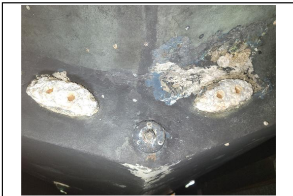
Anodes (zinc) Hull
